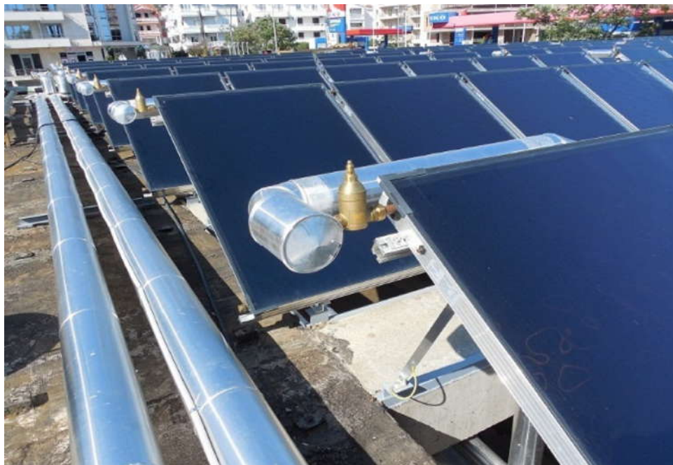
Solarni paneli u TN Slovenska plaža
